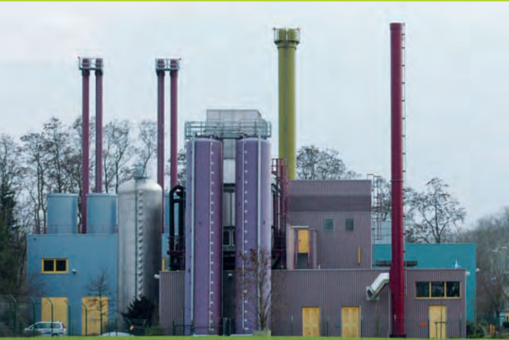
Das BHKW besitzt einen höheren Wirkungsgrad im Vergleich zu herkömmlichen Kraftwerken.
