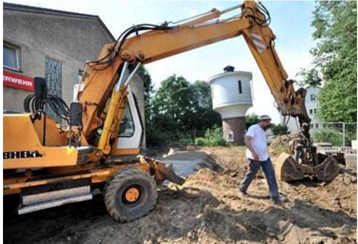
Die Erdarbeiten für die Erweiterung des Gerätehauses an der Atzenbacher Straße haben begonnen. BILD: RALF KRIEGER
