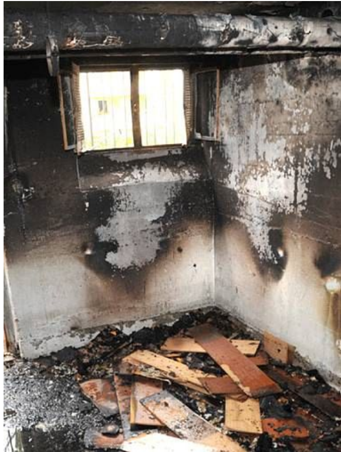
In einem Mehrfamilienhaus an der Unstrutstraße in Rheindorf hat es gebrannt. Das Feuer war im Keller ausgebrochen.
