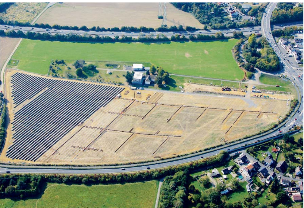
II Der Solarpark Oberlar wurde von der Euskirchener Firma F & S solar concept errichtet.
