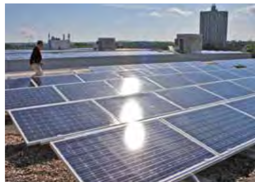
Im Juli 2011 nahm die PHOTON Power AG ihre Photovoltaikanlage auf dem Dach des TZA in Betrieb. Dazu wurden 860 Solarmodule mit einer Leistung von je 255 Watt verbaut.
