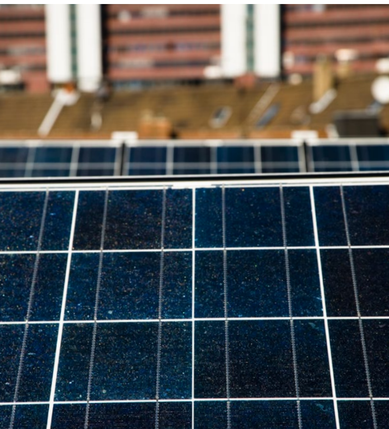
Abb. 28: Beispielbild - Sonnenkollektoren auf dem Dach
