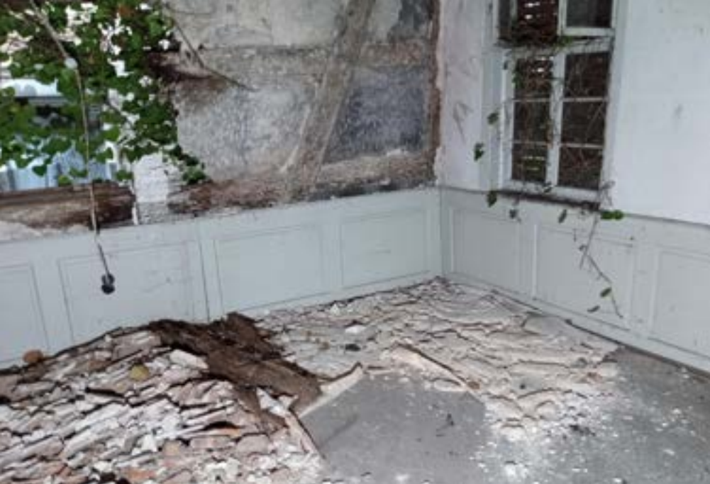
Die Stube im Obergeschoss vor der Sanierung: Der Bewuchs hatte sich bereits bis ins Gebäudeinnere vorgearbeitet
