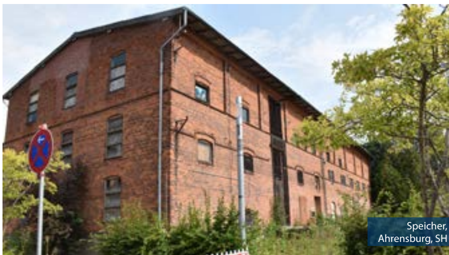
Nachdem der historische Speicher von der Stadt Ahrensburg zurückgekauft wurde, soll die Sanierung beginnen. Doch der jahrelange Verfall hat seinen Zustand massiv verschlechtert.
