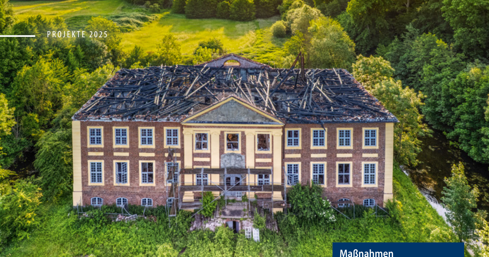
Das Dach des Schlosses wurde durch den Brand völlig zerstört.
