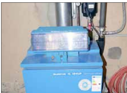
Beispiel Gasheizkessel Anfang der 1990er-Jahre
