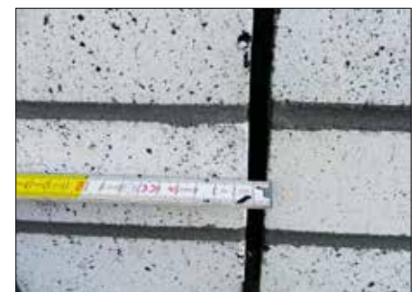
Schadensbild - Offene Fuge, keine Regendichtigkeit
