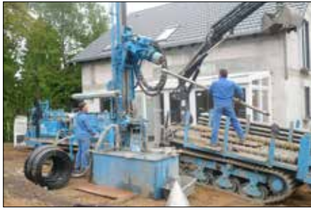
Wärmepumpe mit Tiefenbohrung, Quelle: wikipedia.de
