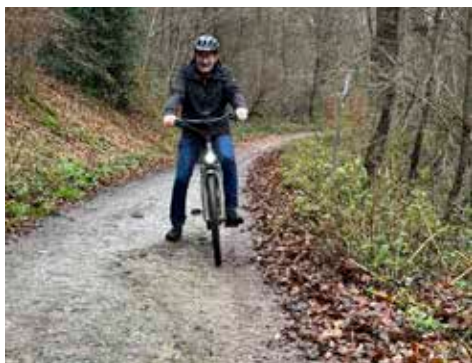
Sturzgefahr durch Senken und Steinkanten
