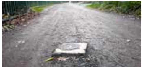
Nicht asphaltierter Weg am Diescholl in Bergheim: Feste Einbauten werden durch Auswaschungen zur Stolperfalle
