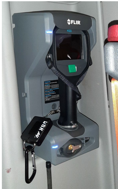
Einbau einer Wärmebildkamera am 11. August 2021
