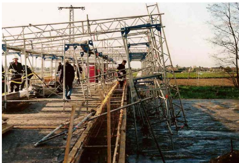
Baugerüst an der Rurbrücke drohte aufgrund des Hochwasser wegzureißen – Einsatz am 1. November 1998
