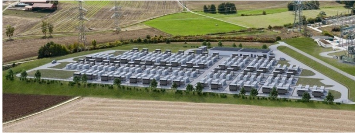
Abb. 25: Netzbooster Kupferzell, Baden-Württemberg – Blick auf Gesamtanlage (Bild: Harrer Ingenieure GmbH)
