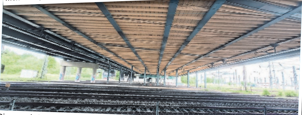
Die marode Brücke wurde bereits von unten abgesichert, jedoch reicht diese Maßnahme nicht aus, um den Verkehr normal über die Fahrbahn rollen zu lassen. Foto: Trzeciak
