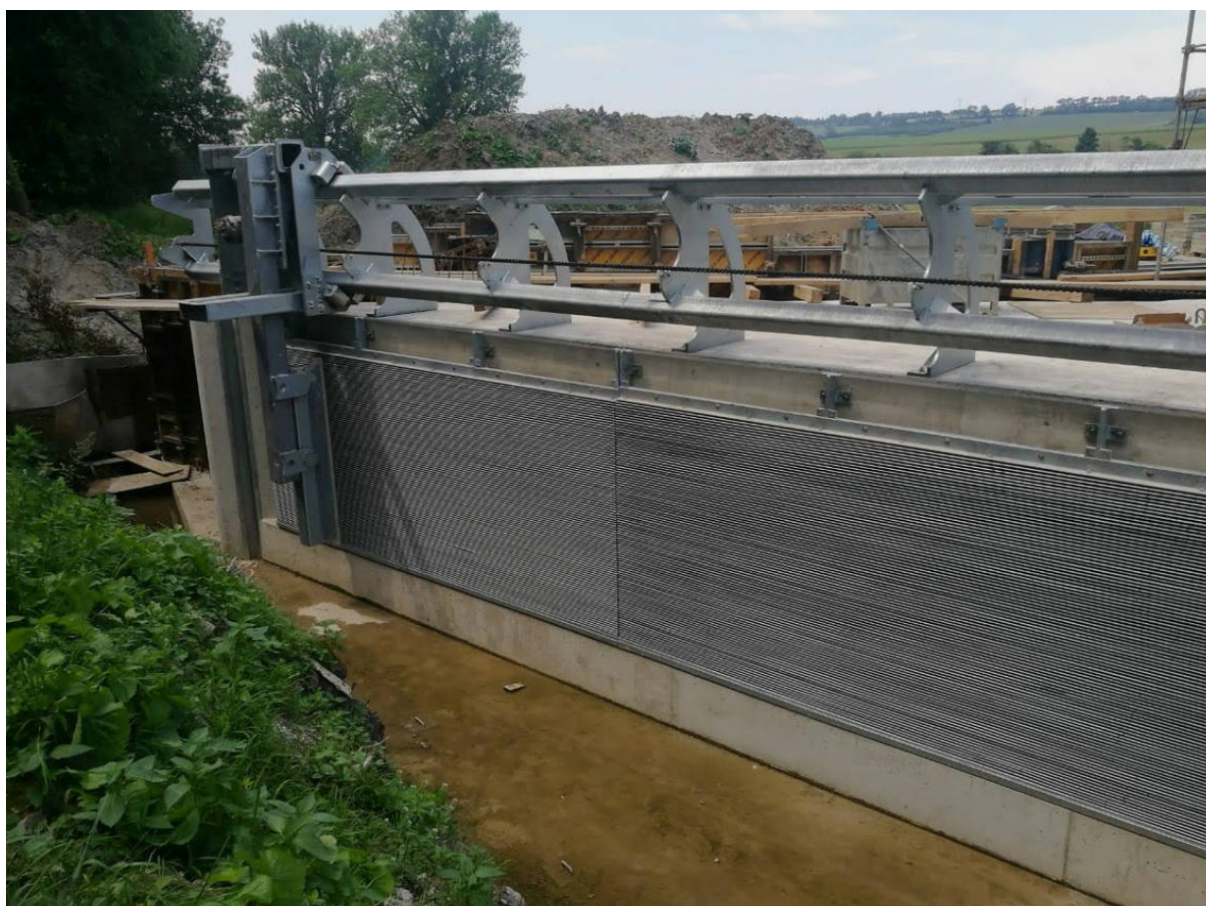
Abb. 8: Beispiel für einen Horizontalrechenreiniger vor der Inbetriebnahme (Quelle: Metallbau-Wasserkraft Onnen Krieger GmbH & Co. KG, 2025).
