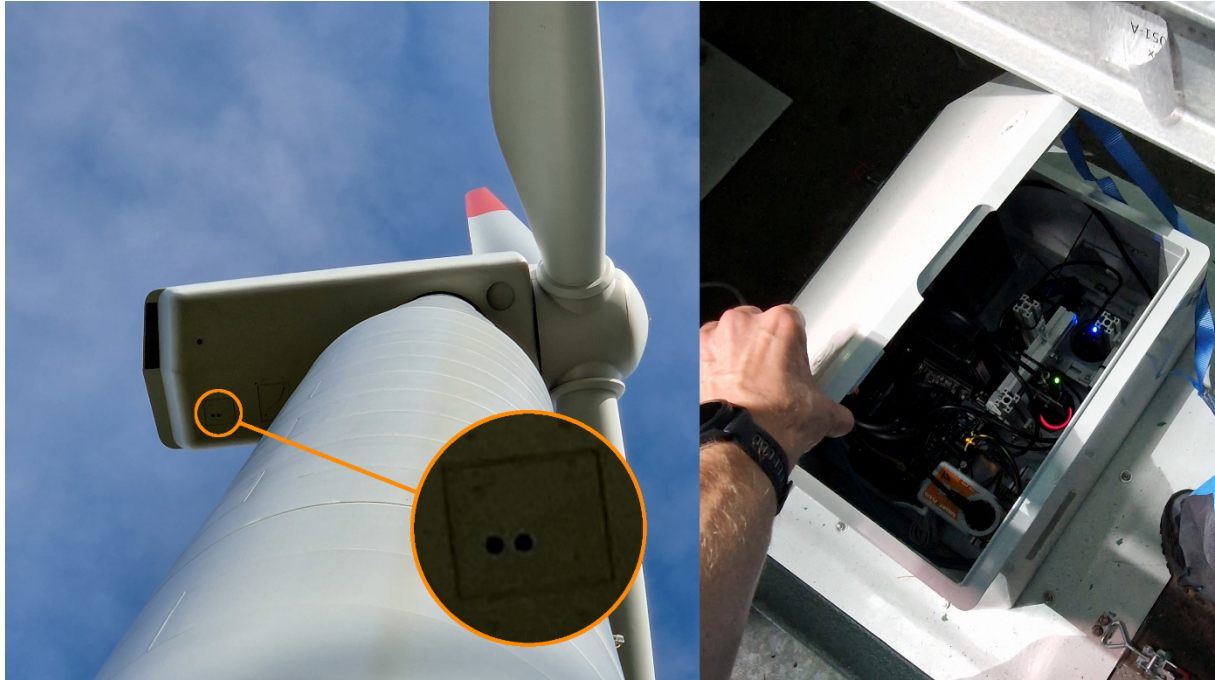
Abb. 107: In der WEA eingebautes Schlagopfersystem: Ansicht Außen (links) und in der Gondel (rechts); Quelle: C. Happ, UMIT Tirol.
