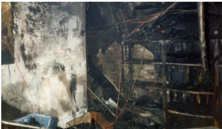
Hier sollte eher ein Fachbetrieb mit der Sanierung beauftragt werden
