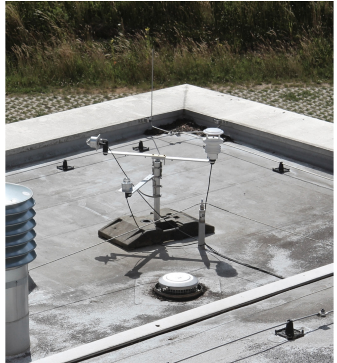
Abb. 245 Wetterstation auf dem Dach des Anbaus
