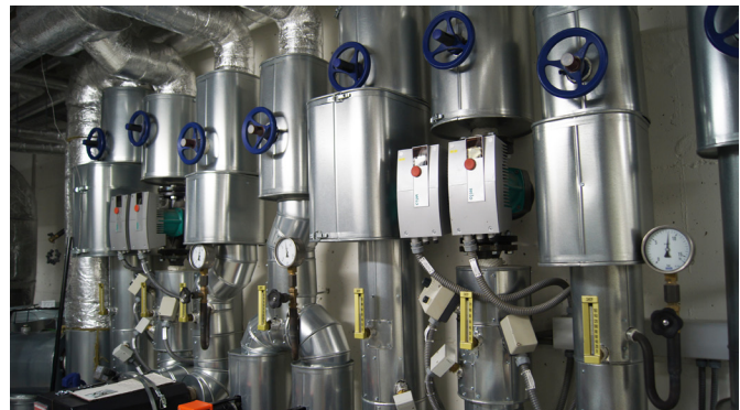
Abb. 228 Fernwärmeversorgung Scharoun Theater Wolfsburg
