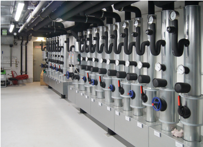
Abb. 81 Fernwärmeverteilung im Opernhaus Bonn
