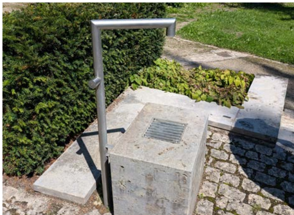
Barrierefrei zugänglicher Wasserhahn in Weimar
