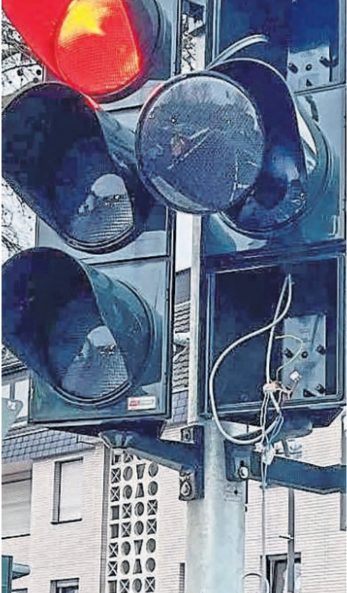
Die Ampel an der Tankstelle (Berliner Straße, Ecke Odenthaler Straße) in Köln-Dünnwald wird immer wieder angefahren. Foto: Rainer Weber
