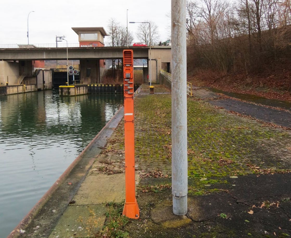
Gegensprechanlage im Vorhafen einer Schleuse
