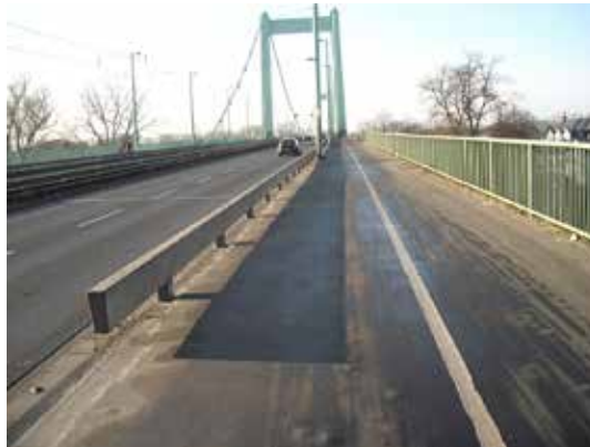
Die Mülheimer Brücke vor dem Beginn der Sanierung: Autos haben viel Platz, Fuß- und Radverkehr teilen sich die enge Nebenanlage.
