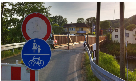
Die schwer beschädigte Brücke ist derzeit nur für Fußgänger und Radfahrer zu nutzen.
