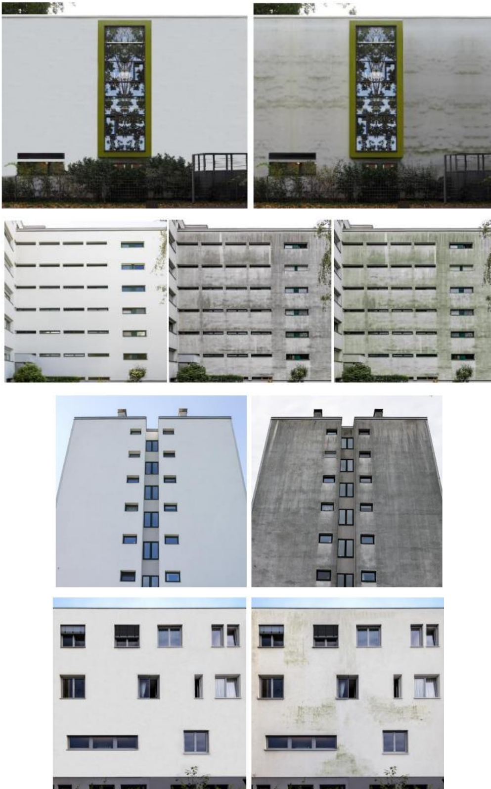
Abbildung 77. In den Fragebogen integrierte Fassaden zur Bewertung der ästhetischen Wirkung des Biofilms, von oben nach unten: Gebäude 1,2,3, und 4 (Quelle: TUD/SGB)
