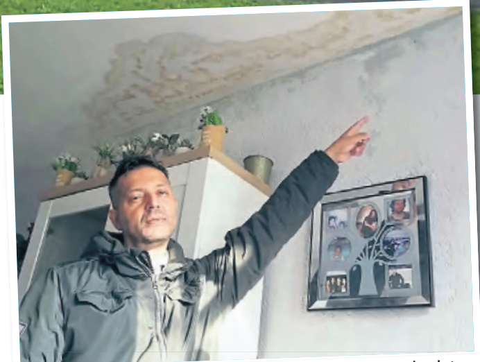
Kosta Chaimanatzis wohnt seit 2010 in dem Haus und zeigt die Schäden in seiner Wohnung. Foto: Trzeciak
