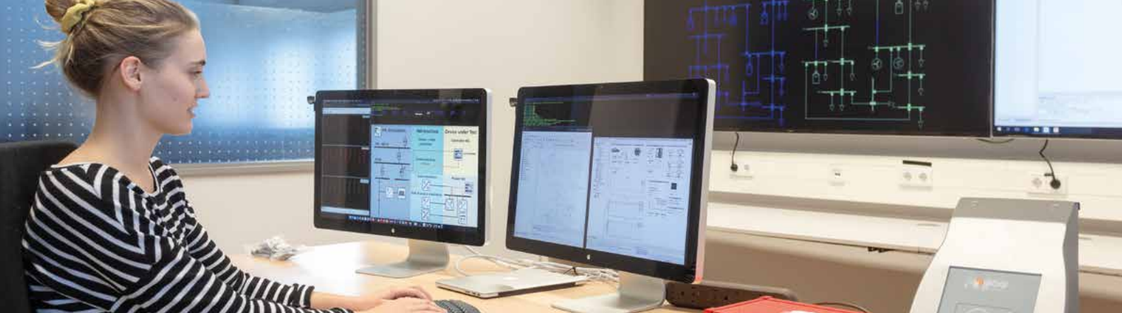
Leitwarte im Digital Grid Lab des Fraunhofer ISE als zentrale Schaltstelle für den Netzbetrieb mit KI-Verfahren | Quelle: Fraunhofer ISE
