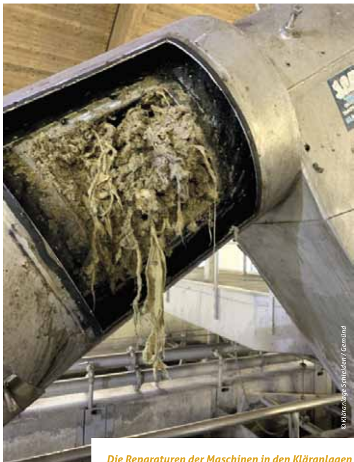
Die Reparaturen der Maschinen in den Kläranlagen verursachen hohen Kosten, die im Ergebnis auch Auswirkungen bei der Gebührenkalkulation haben
