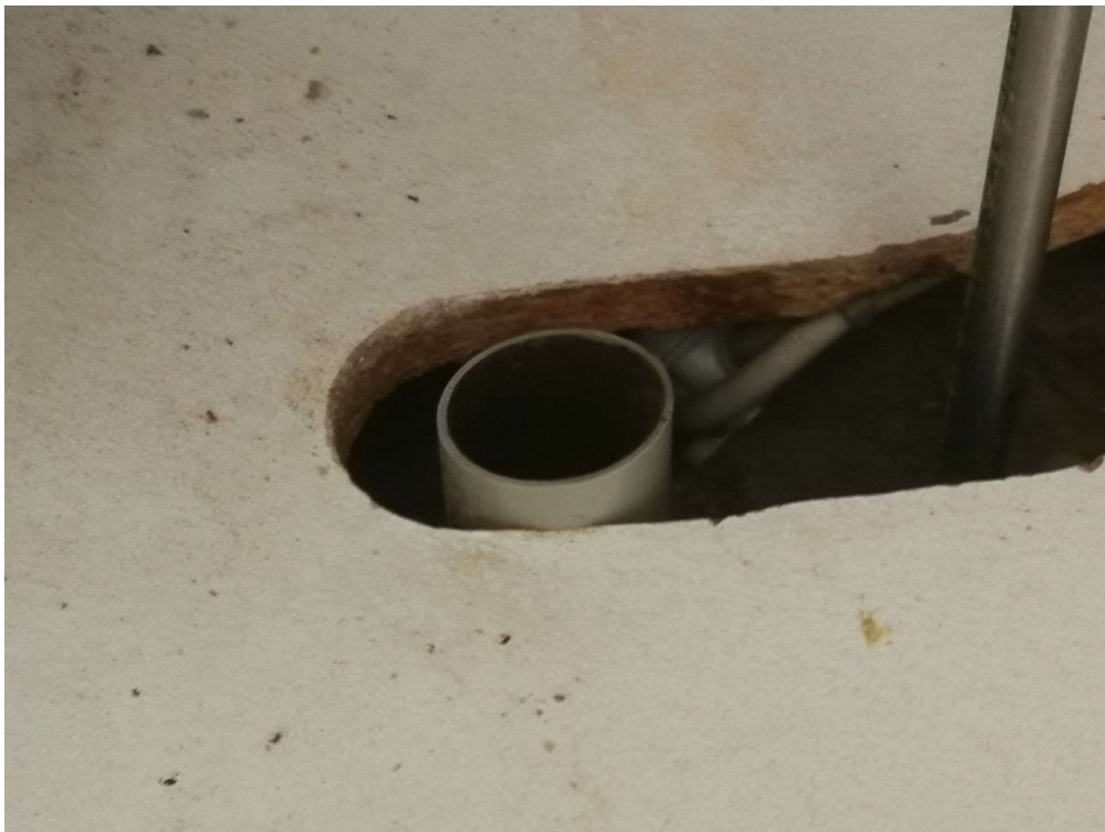
Foto 15: „Belüftungsröhr?“ unter einer Spüle
