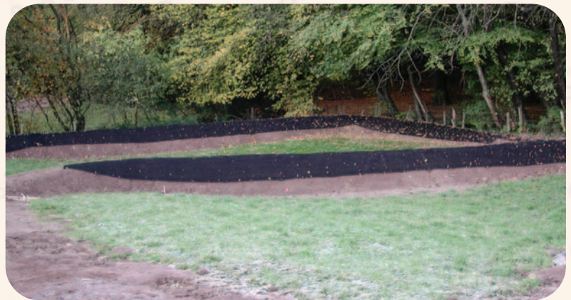
Anlage einer Mulde zur Versickerung von Niederschlagswasser von Straßen und Dachflächen aus einem Wohngebiet in Scheideweg, Stadt Hückeswagen.
