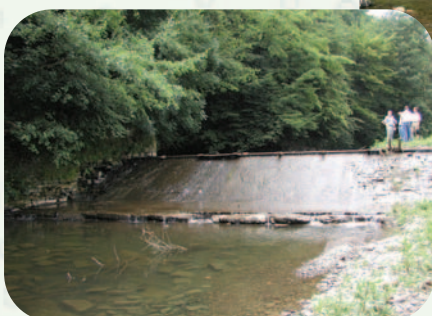
Wehr Krummenohl vor/nach der Renaturierung: Wehranlagen stellen eine starke Beeinträchtigung des Lebensraums Fließgewässer dar.
