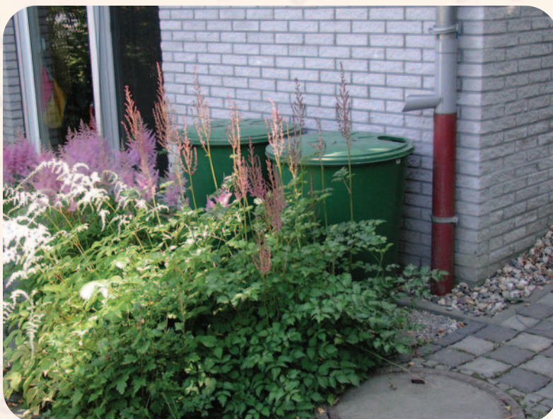
Ahornweg, Stadt Hückeswagen: Die einfachste Form der Regenwassernutzung ist die Regentonne zur Gartenbewässerung.
