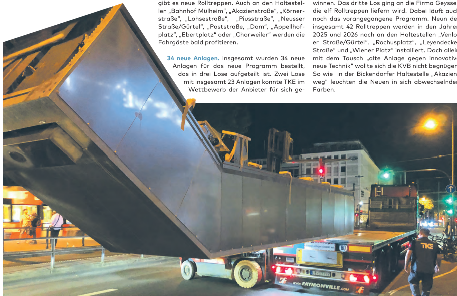
Eine neue Rolltreppe fährt vor: Für den Ein- und Ausbau der Anlagen sind sehr aufwändige Arbeiten erforderlich
