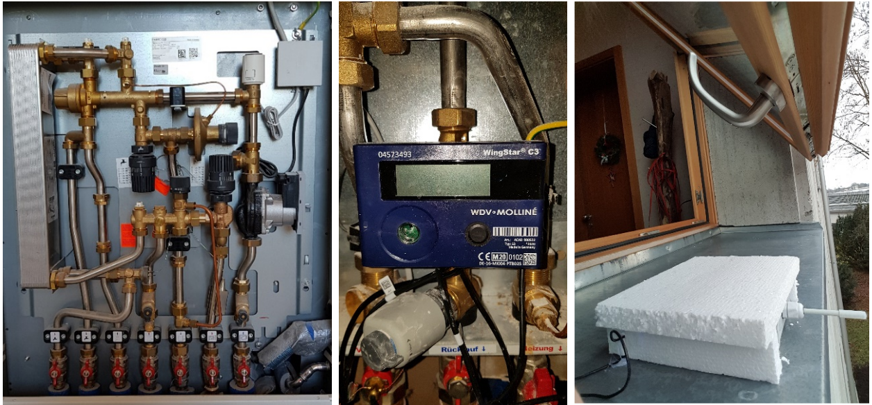
Abbildung 50: links: dezentrale Wohnungsstation für TWW und Heizen der Firma Strasshofer; mitte/rechts: Wärmemengenzähler und Funkverstärker der WDV Molliné GmbH
