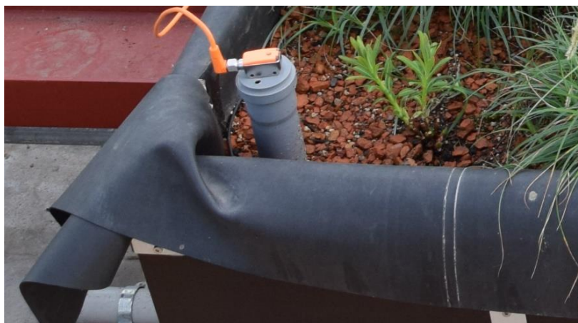
Abb. 9: In einem Steigrohr montierter Ultraschall-Sensor zur Messung des Wasserstands (Quelle: HSWT)
