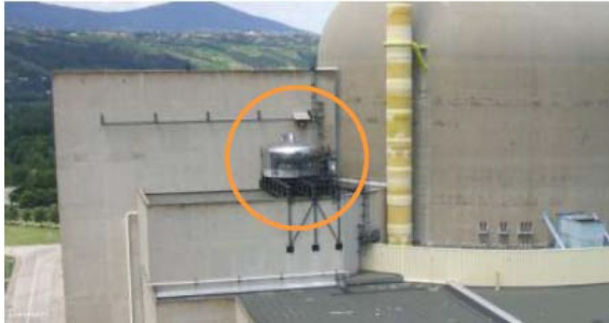
Abb. 3.2 Anbringung des Filters außerhalb des Containments
