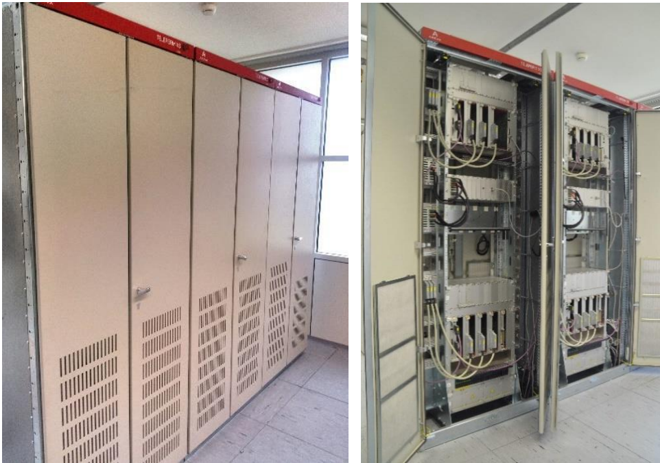
Abb. 1.2 Das Modul AnTeS-SILT-real, ein reales Sicherheitsleittechniksystem basierend auf Teleperm XS
