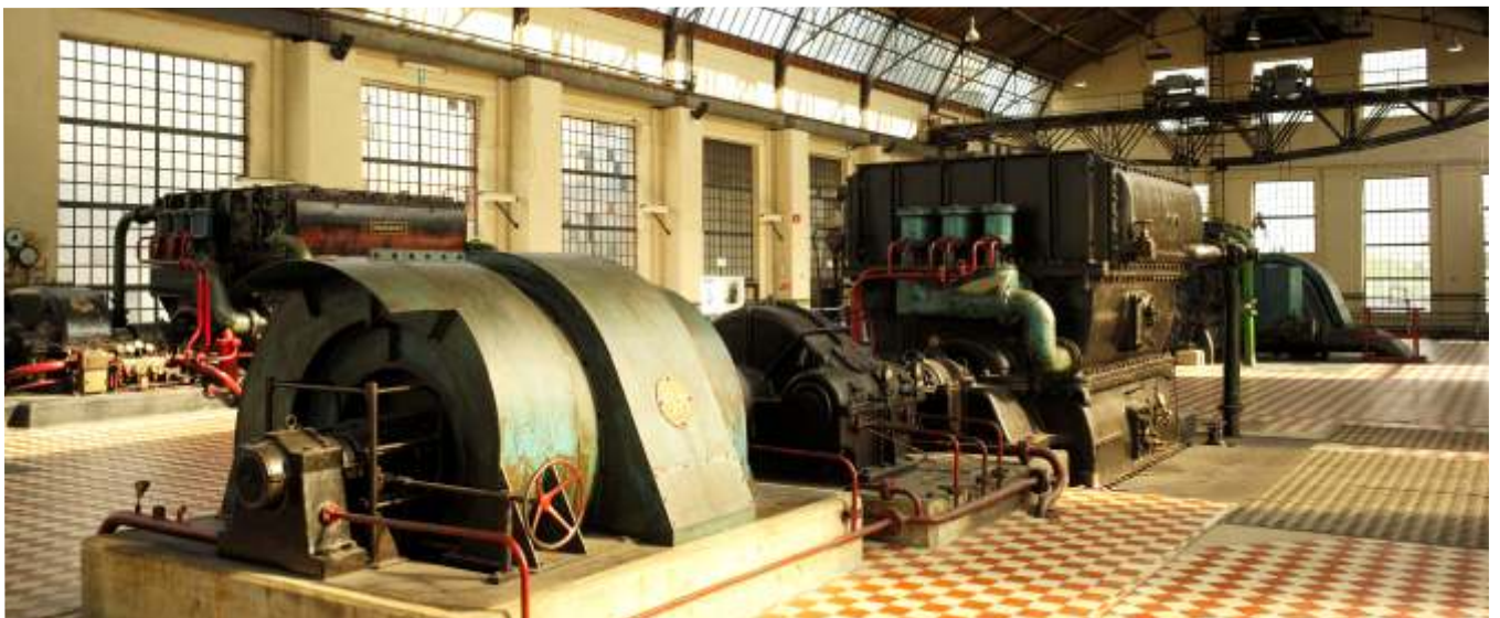
Verdichter in der renovierten Maschinenhalle der Zeche Winterslag (2014)
