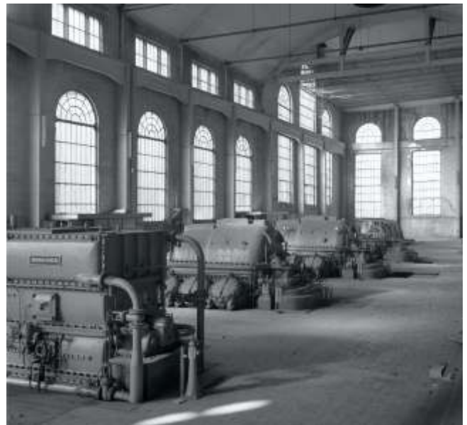
Verdichter in der Maschinenhalle der Zeche Eisden. (1990)
