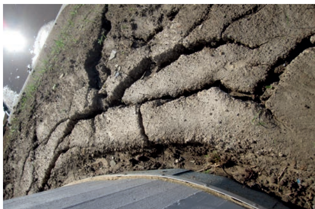
Bild 22: Setzrisse im Hügelboden durch heftige Regenfälle 16.7.2014
