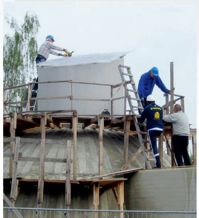
Bild 2: provisorische Abdeckung des Lichtschachtes am 6.6.2014
