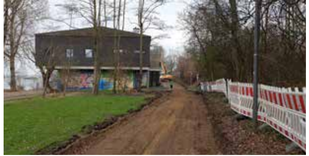
Am Oberkasseler Bootshaus: Der Rheinradweg wird auf drei bis vier Meter verbreitert.
