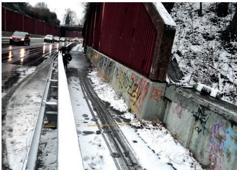
Am Brückenende Richtung Mondorf beträgt die Wegbreite nur 1,40 Meter. Der ADFC fordert, eine schmalere Leitplanke fahrbahnnäher aufzustellen.
