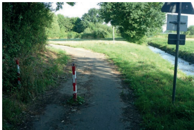
Überflüssiger und kaum erkennbarer Poller nach einer Kurve auf dem Radweg an der Swist. Hier fahren am Wochenende Tausende von Radlern.
