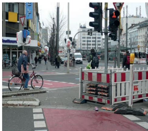
Kein Zustand am Belderberg: Die mobilen Ampeln für den Linksabbieger zum Suttner-Platz wurden einfach auf Geh- und Radwege platziert. Der Radweg war nur noch halb so breit.
