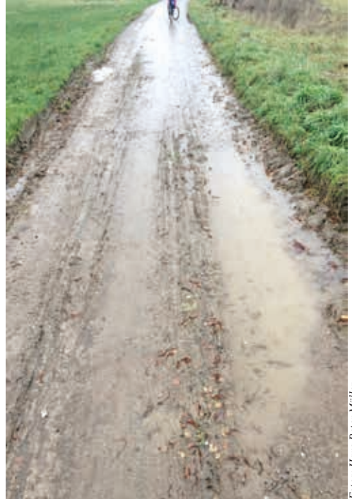
Lessenicher Weg: Gefahren- und Schmutzquellen
