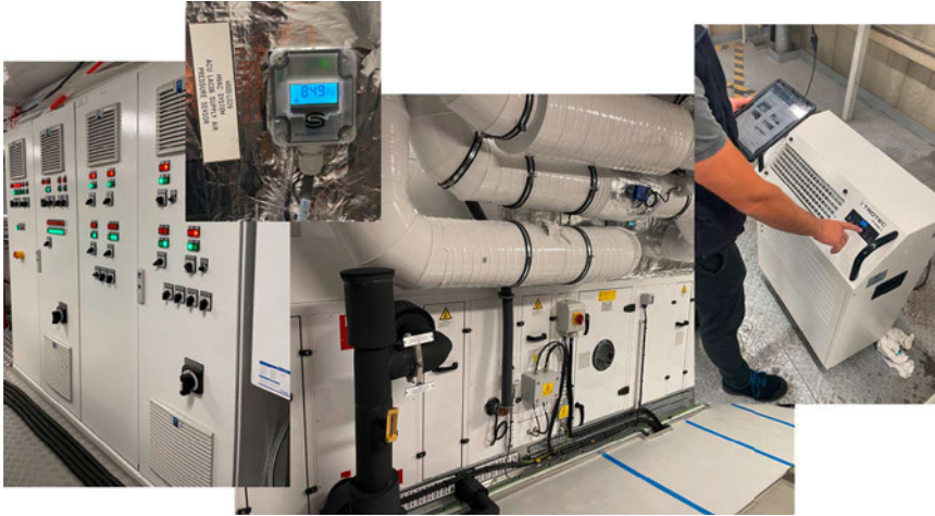
Abb. 10: Stationäre und mobile Air-Conditioning-Anlagen, an Bord bei Abeking & Rasmussen
