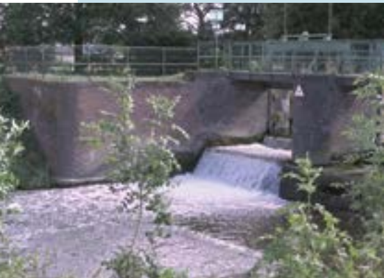
Bewegliches Wehr in Ertfstadt-Brüggen
