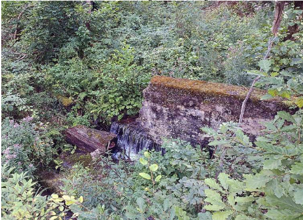
Eingefallene Staumauer im Bachlauf
