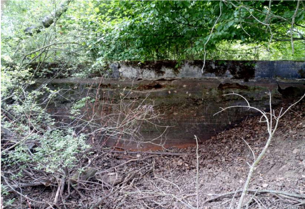
Ausgetrockneter Löschteich auf der Leuscheider Heide im Sommer 2022
