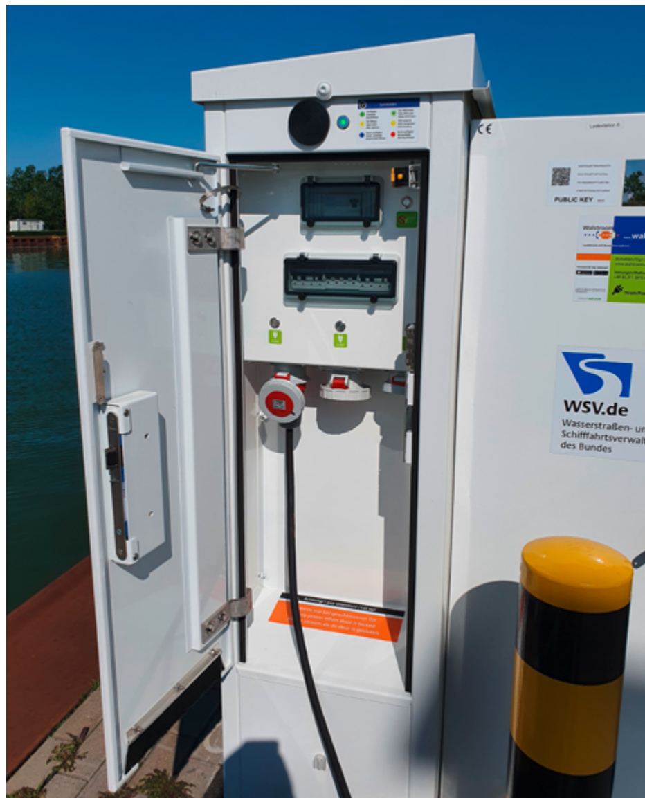
Anschlusseinheit einer Binnenschifffahrtssäule
