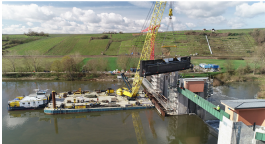
Einhub eines Rollschützes am Wehr Horkheim
