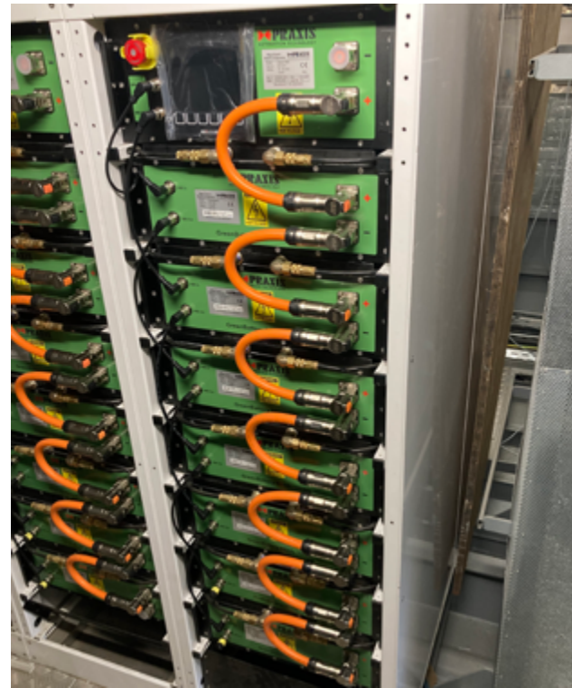
Batterierack mit sieben Batteriemodulen à 10 kWh
