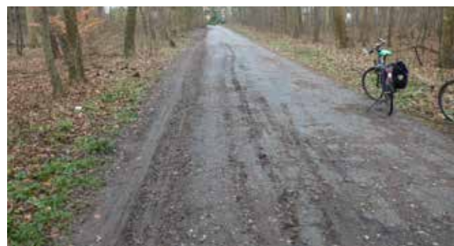
Seit vielen Jahren prägen Schlaglöcher und Unebenheiten diesen Abschnitt der Heimersdorfer Straße. Doch erst im März 2023 kommt es zu einem Sanierungsbeschluss.
