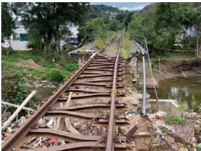
Die Flutkatastrophe im Juli 2021 zerstörte viele Gleisanlagen und Eisenbahnbrücken im Tal der Erft. Seitdem ruht der Bahnbetrieb zwischen Euskirchen und Bad Münstereifel
