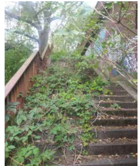
Treppe zum ehemaligen Bahnhof Mödrath, die – wie auch der Rest des Bahnhofs – im Dornröschenschlaf liegt.
