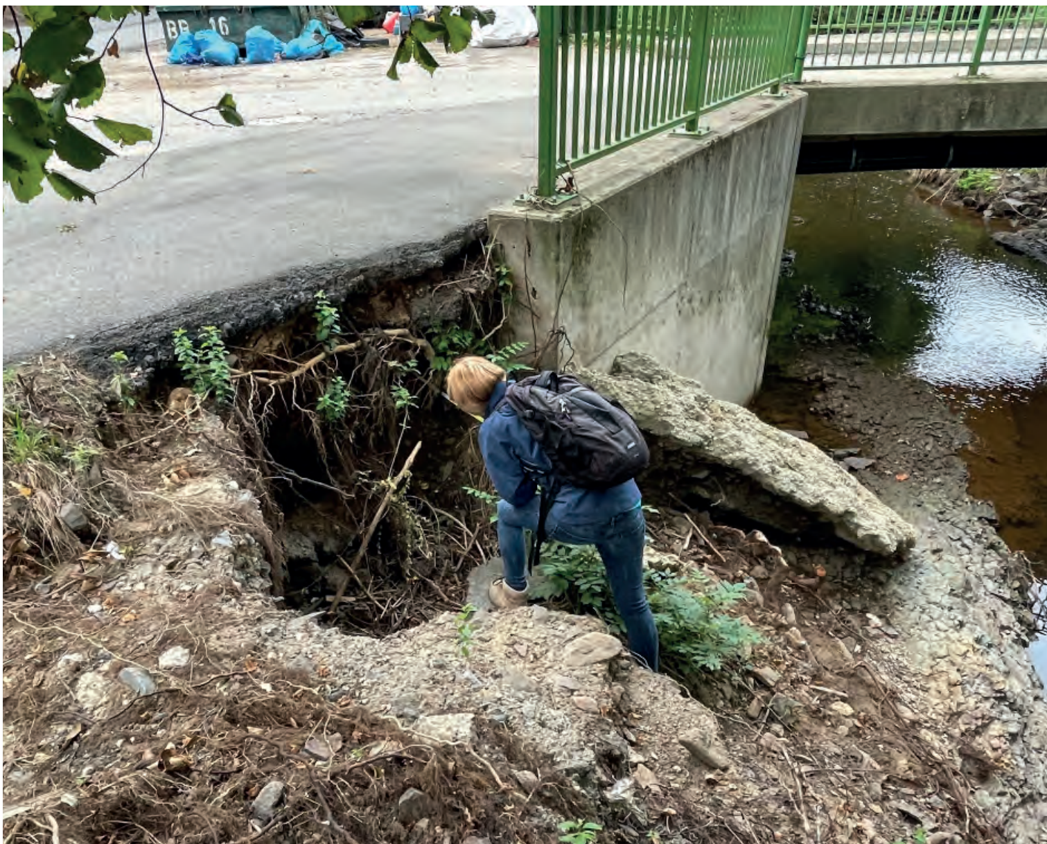
Bild 5: Schaden an einer Brücke bei Zweifall
