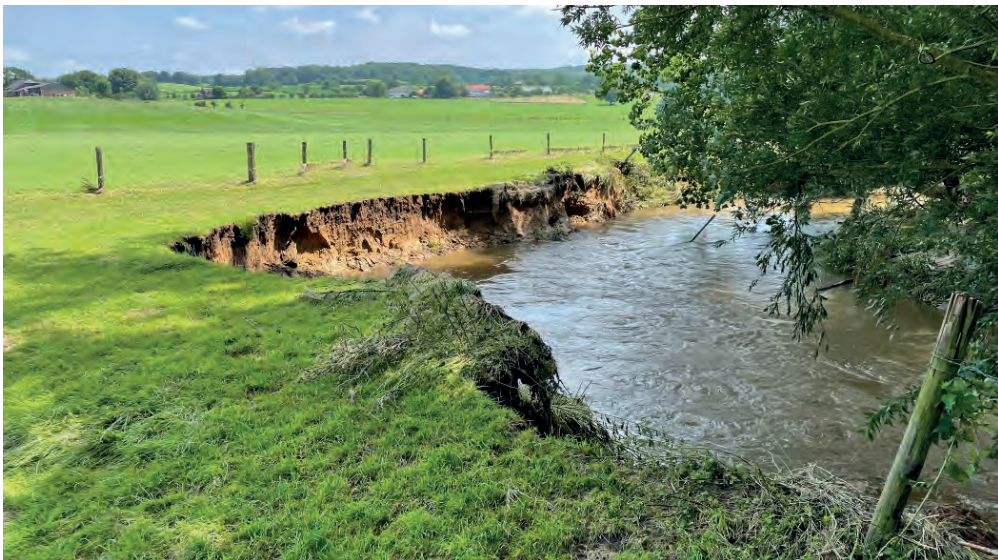
Bild 6: Oben: Lateralerosion am Vichtbach. Unten: Kolk, entstanden durch Lateralerosion an der natürlichen Uferböschung der Geul Fotos: Frank Lehmkuhl, 17.7. und 24.7.2021
