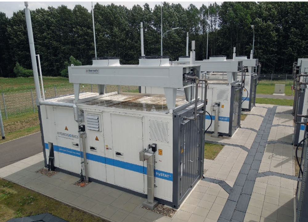
Abb. 2: Power-to-Gas-Energieanlage im brandenburgischen Falkenhagen
