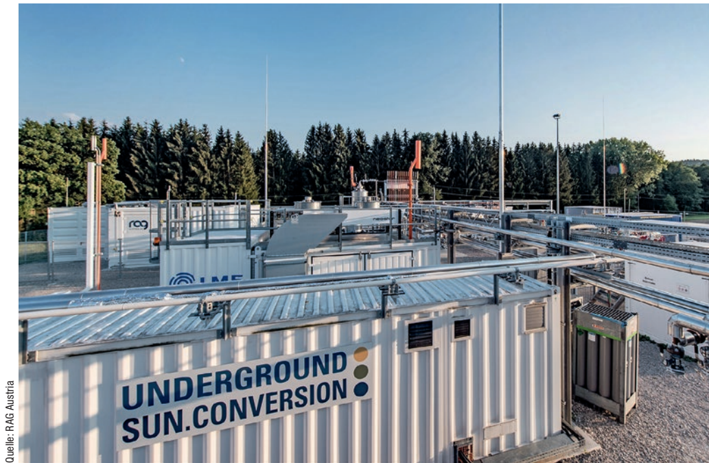
Abb. 3: Feldtest-Anlage der RAG Austria zur Geo-Methanisierung in einem ausgeförderten Porenspeicher
