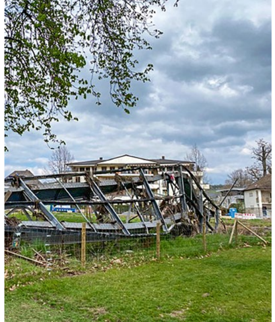
Brücke im Kurpark Bad Neuenahr nach der Flut
