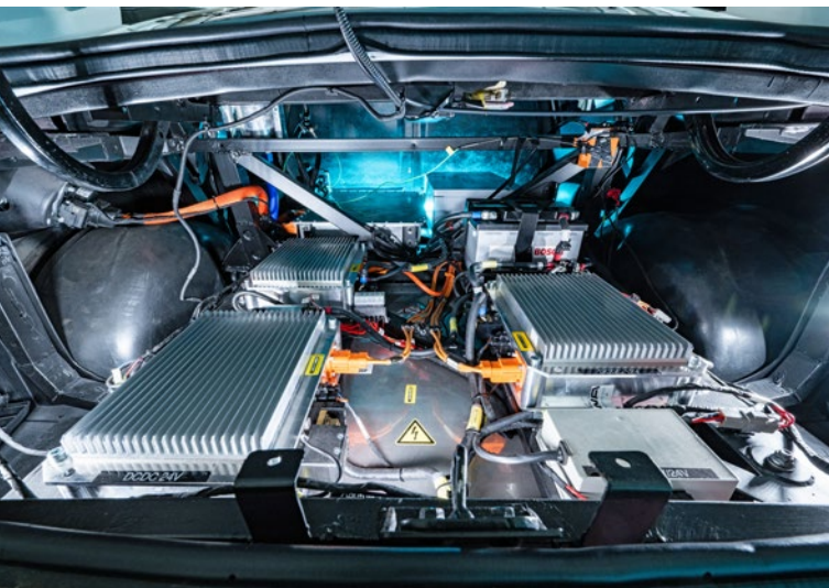
Im Fahrzeugheck sind die Batterie, die Leistungselektronik sowie die Gleichspannungswandler zur Stromversorgung verbaut.
