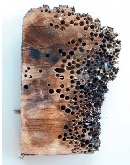
Fraßbild der Bohrmuschel in einem Eichenbalken
